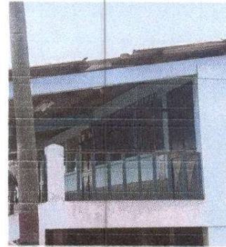
Foto 2: Lamina quebrada. Modulo 3.
