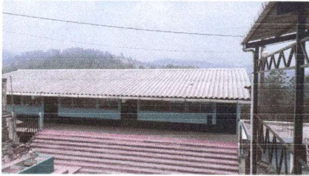
Foto 1: Techo en mal estado, laminas quebradas y entra el agua. Modulo 3
